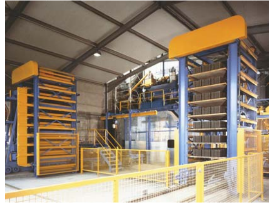
Abb. 4.2.5-1: Produktionshalle, Ringanlage mit Hub- und Senkleiter
