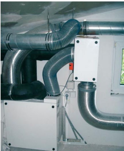
Lüftungsgerät: Zu-/Abluftanlage mit Wärmerückgewinnung
