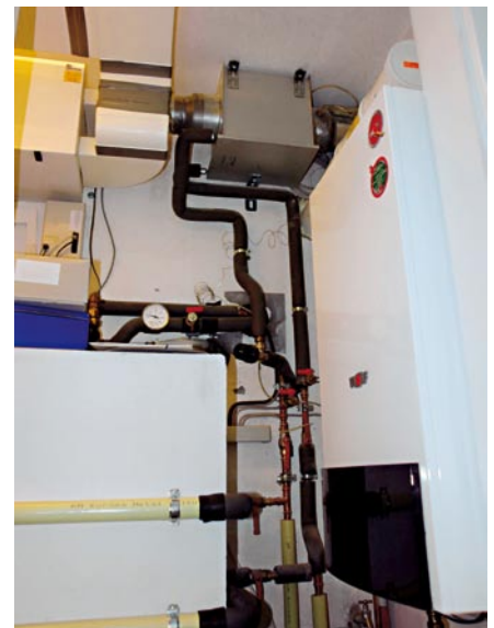
Gasbrennwertgerät im Dachgeschoss
