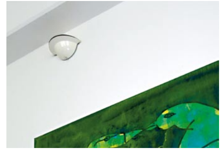
Weitwurfdüse der Lüftungsanlage
